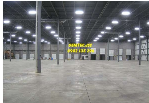
Hệ thống điện chiếu sáng
