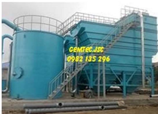
Bể lắng lamella
