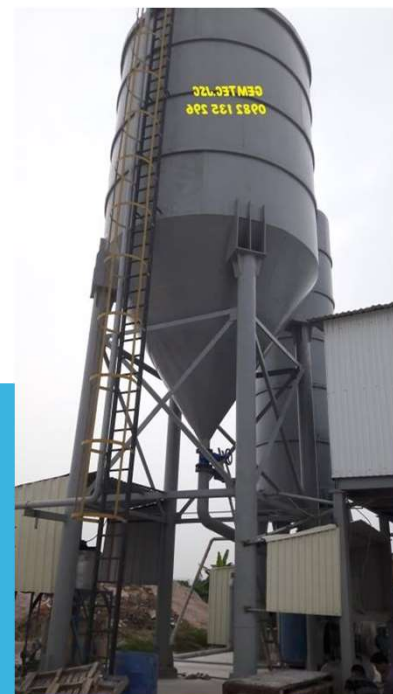
Tháp xử lý nước
