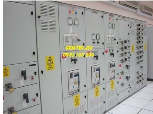
Hệ thống điện điều khiển
