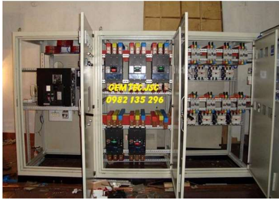
Hệ thống điện động lực
