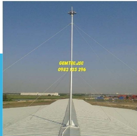
Hệ thống chống sét
